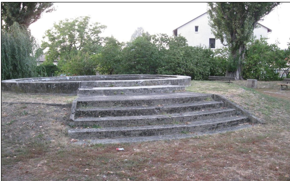
Zdjęcie 16. Zły stan techniczny przestrzeni publicznych (ulica Szczeszyńskiego).
