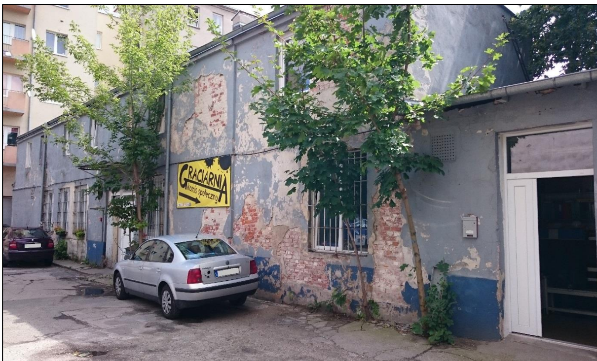
Zdjęcie 12. Niezagospodarowane (zdegradowane) dziedzińce oraz wnętrza międzyblokowe.
